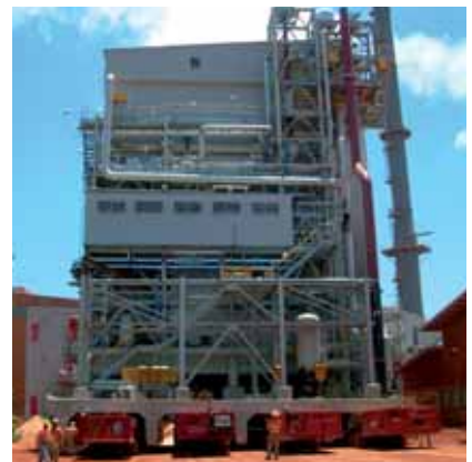
Gove G3 Boiler 7
